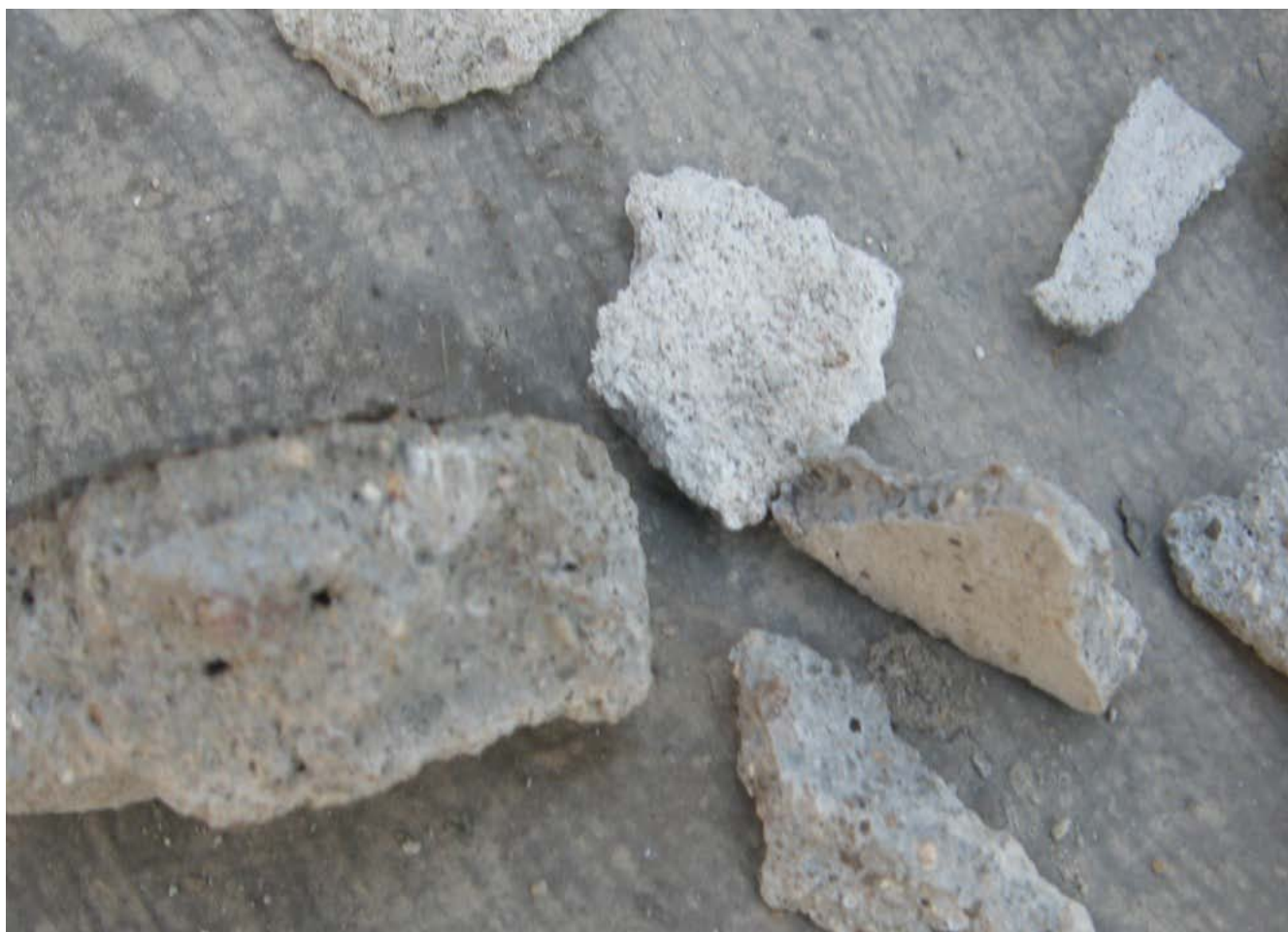
顶楼可以是偷工减料？何不检测？何时落实？造成渗水漏水严重。国家的屋面工程是这种标准？
