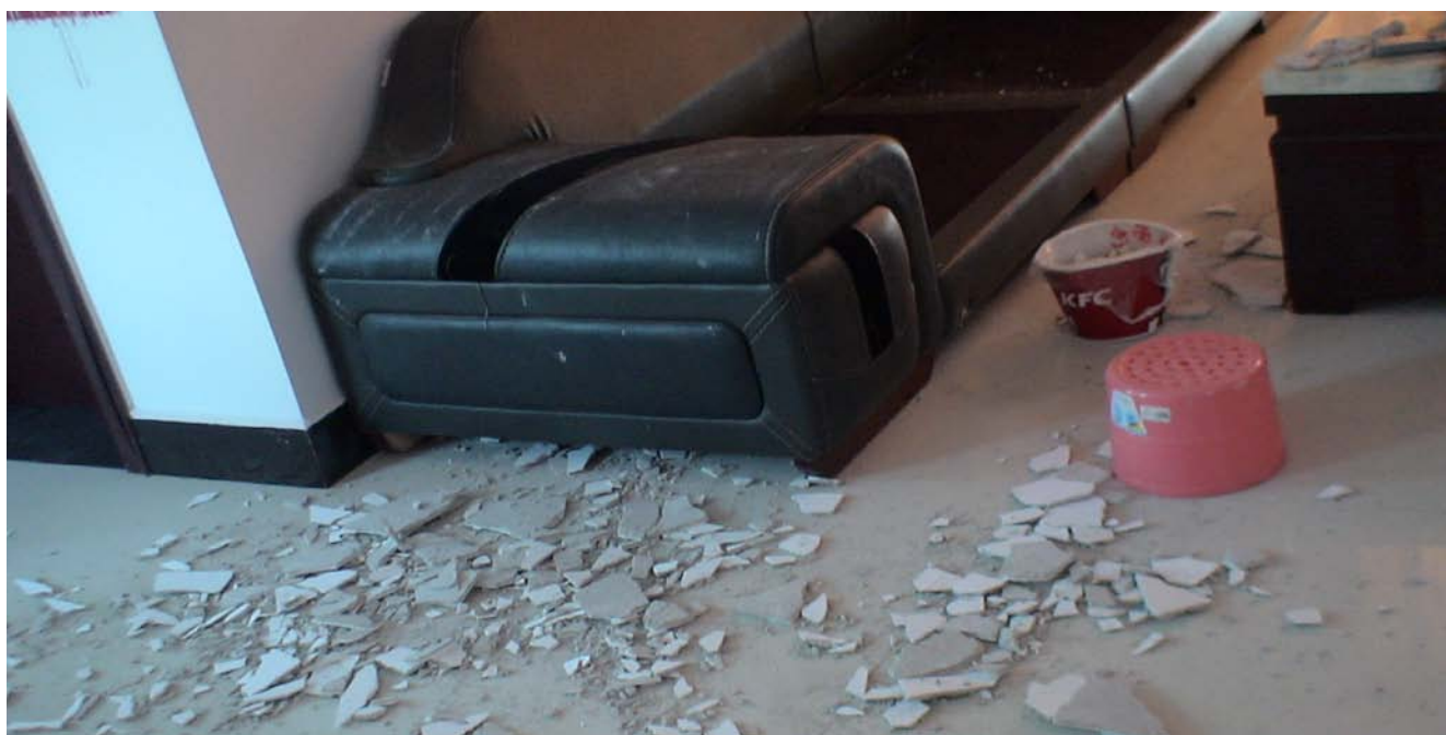
A座4单元701 天花板塌下来了
