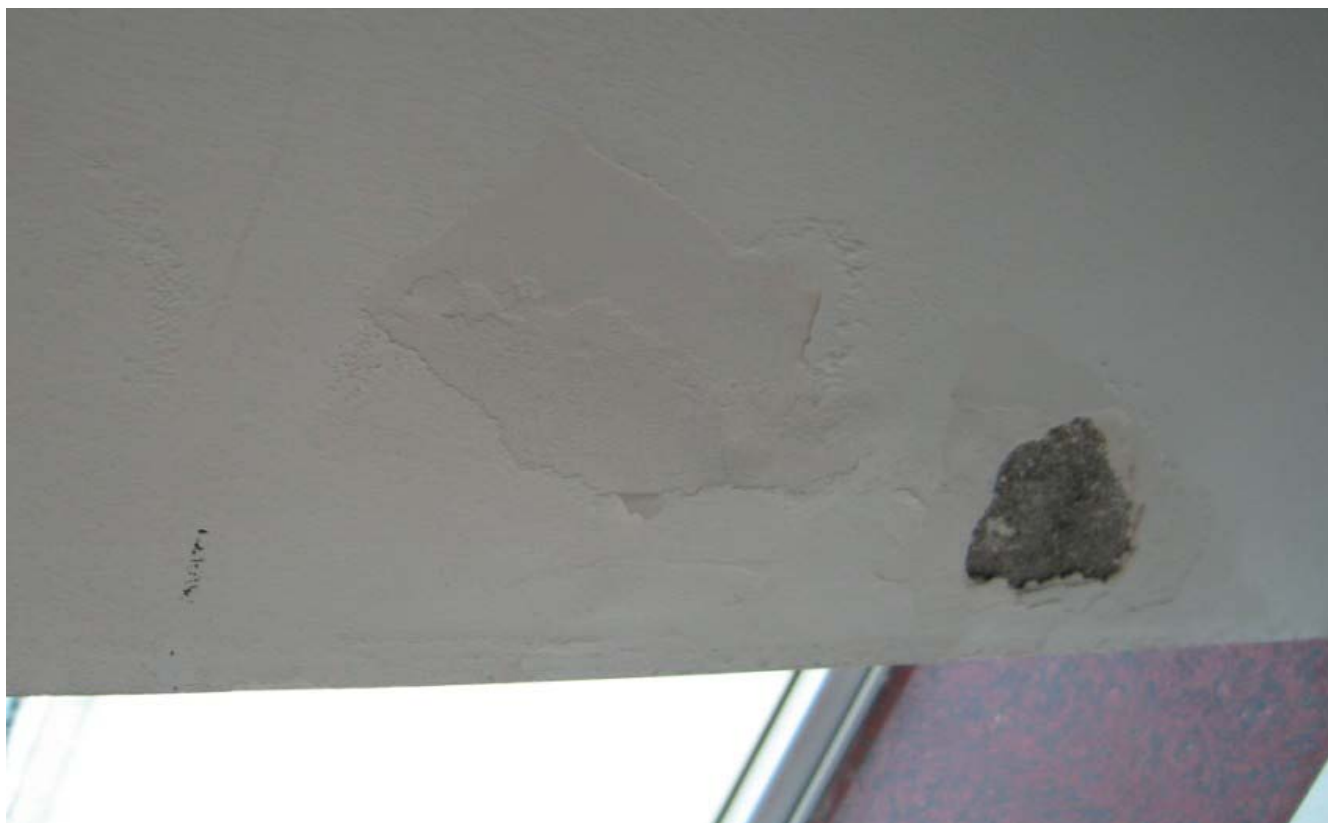
B座1单元701阳台墙体漏水渗水造成的。
