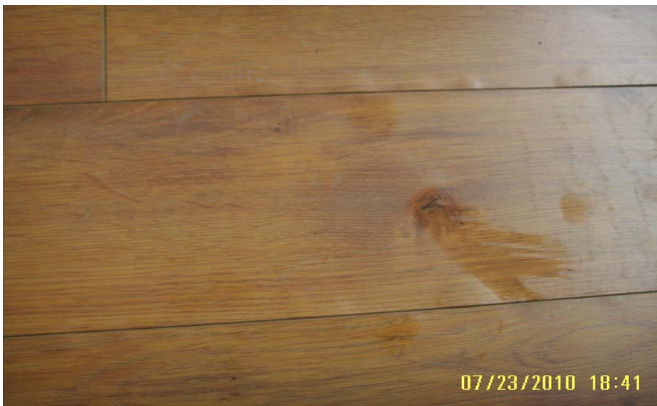
A座2单元501因为窗漏水，造成的木地板积水。木地板变形
