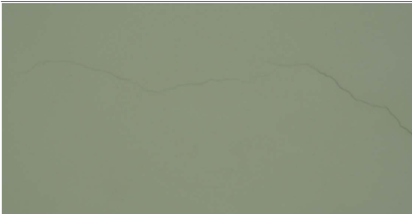
B座1单元702房间的房顶裂痕直通房顶两端，何为安全？
