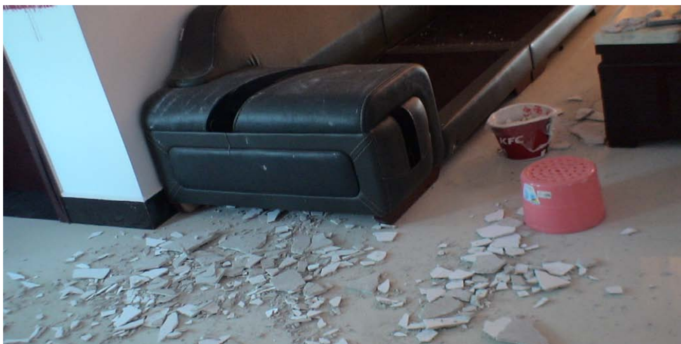
A座4单元701 天花板塌下来了
