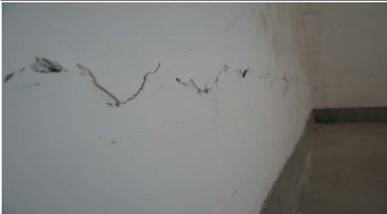
楼道墙体裂开，现在有的地方是二条或三条裂痕了。他们修缮不到一个月又出现了！新修的石灰面都清晰可见。
